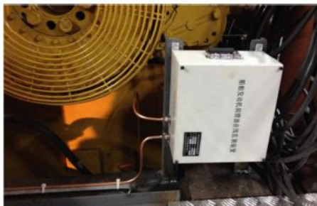
图 4 油液在线监测系统实际使用现场
